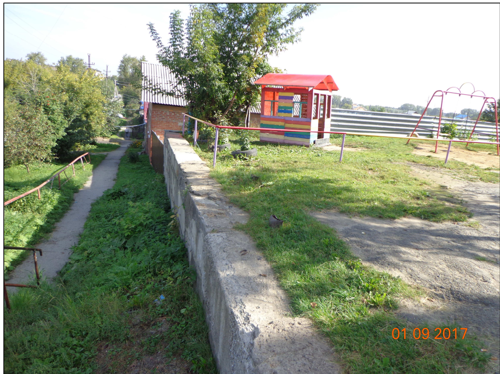
Рис.10. Отсутствие высокого ограждения в опасной зоне (резкий перепад уровня земли)
