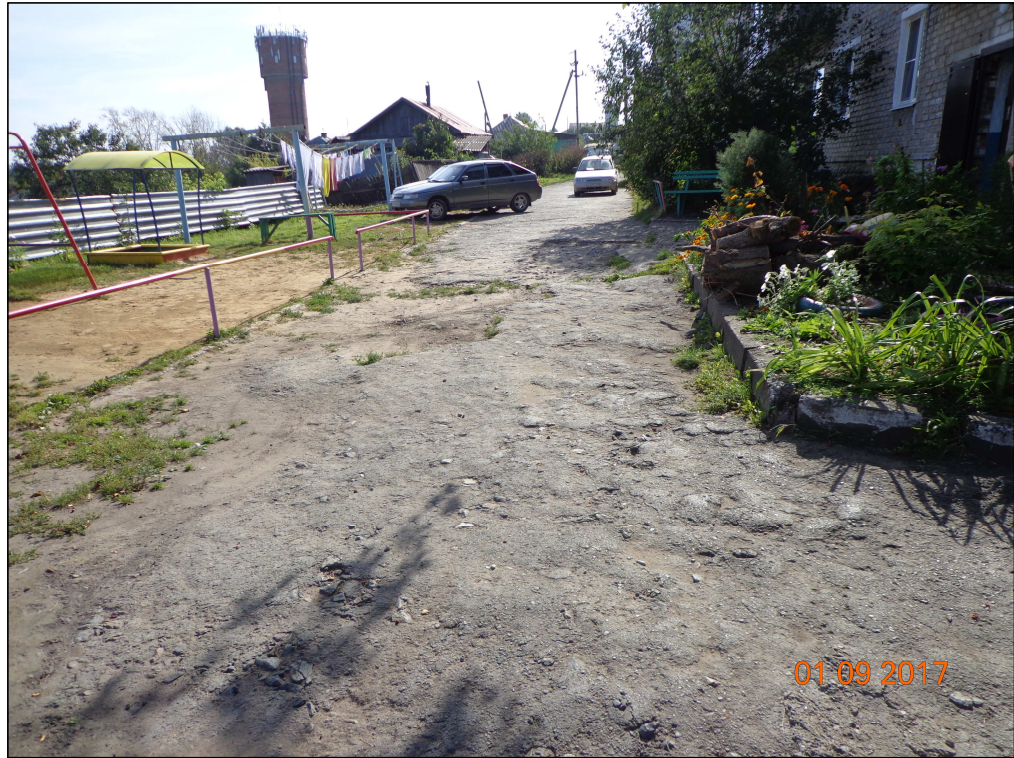
Рис.9. Износ дорожного покрытия
