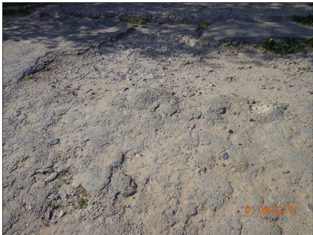
Рис.6. Износ и разрушение дорожного покрытия, выбоины
