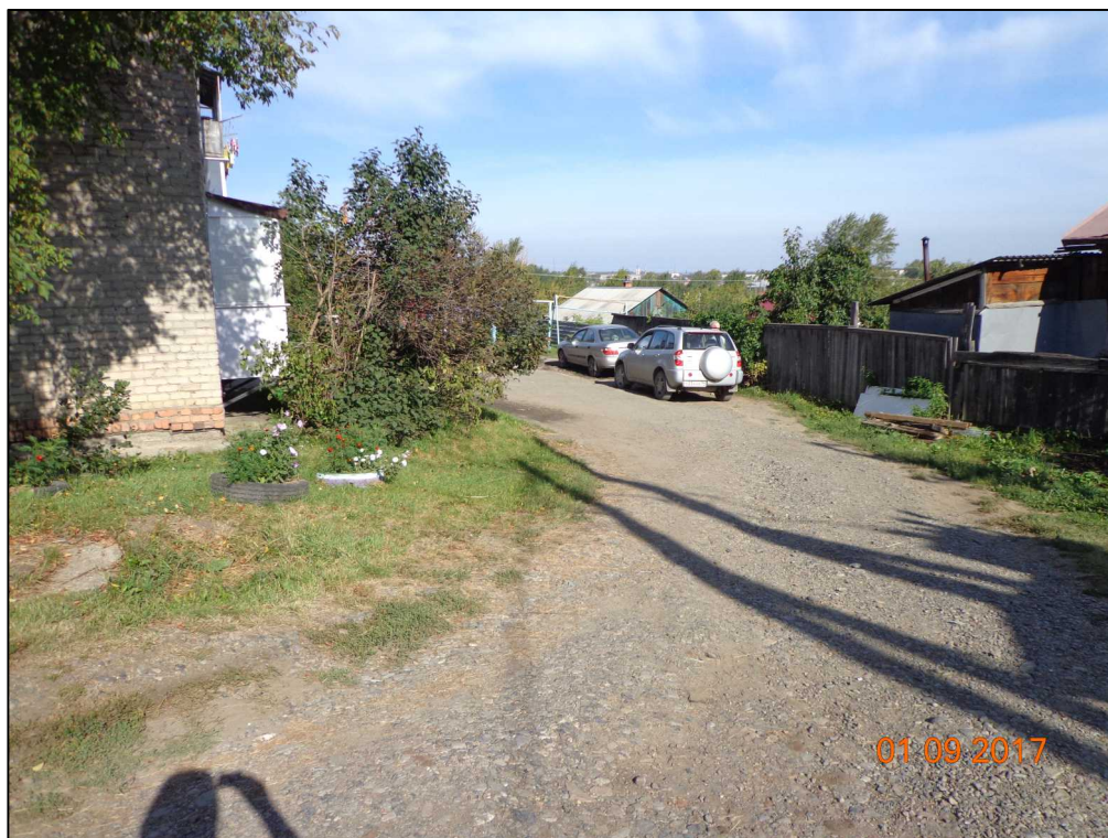
Рис.1. Износ и разрушение дорожного покрытия. Отсутствие ограждения и бордюрного камня
