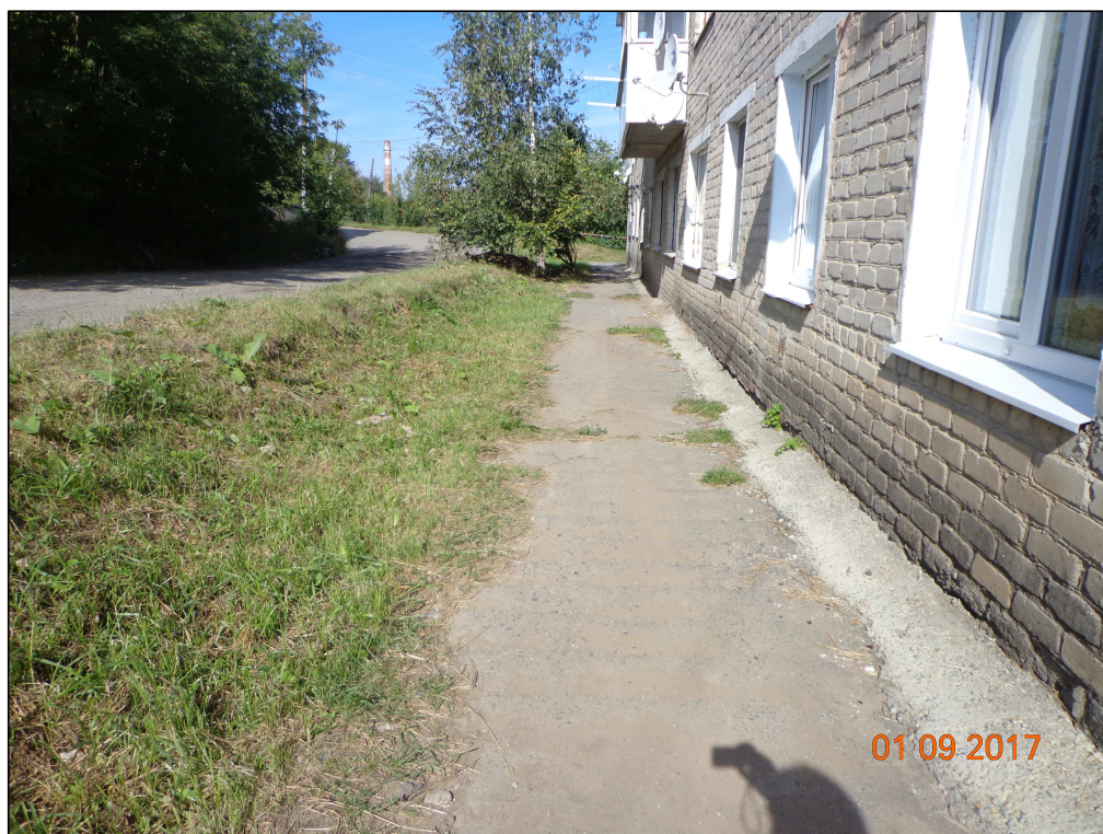
Рис.8. Износ тротуарного покрытия
