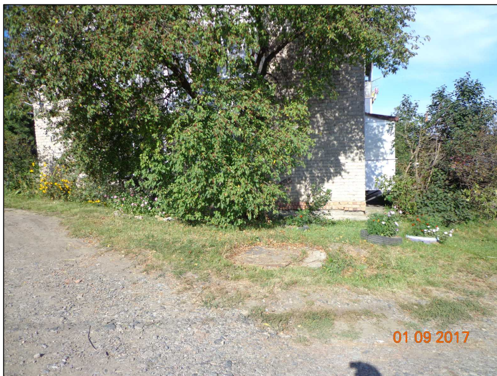
Рис.2. Износ и разрушение дорожного покрытия. Отсутствие ограждения и бордюрного камня
