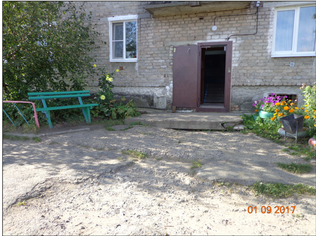
Рис.5. Износ и разрушение дорожного покрытия, выбоины, впадины, разный уровень земли
