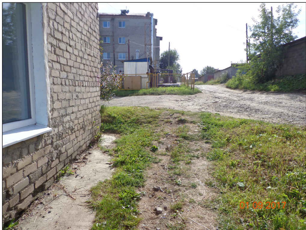
Рис.14. Износ тротуарного покрытия
