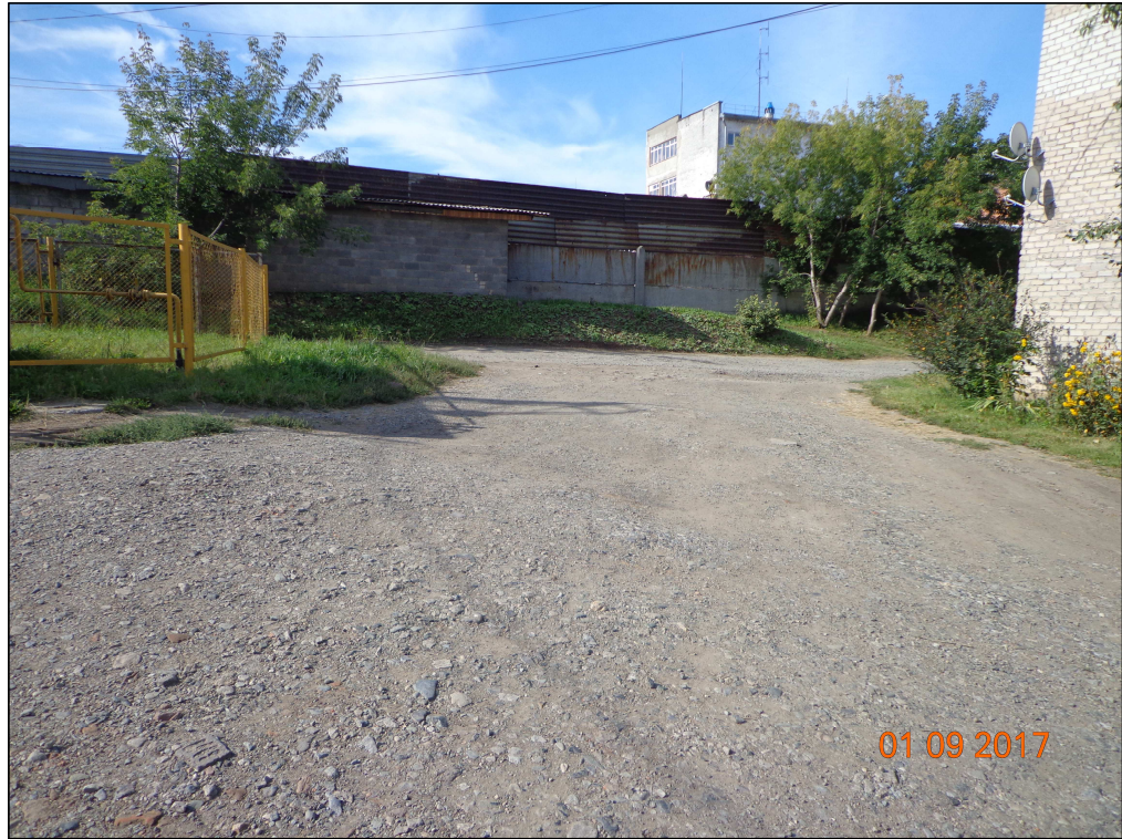
Рис.13. Отсутствие асфальтового покрытия
