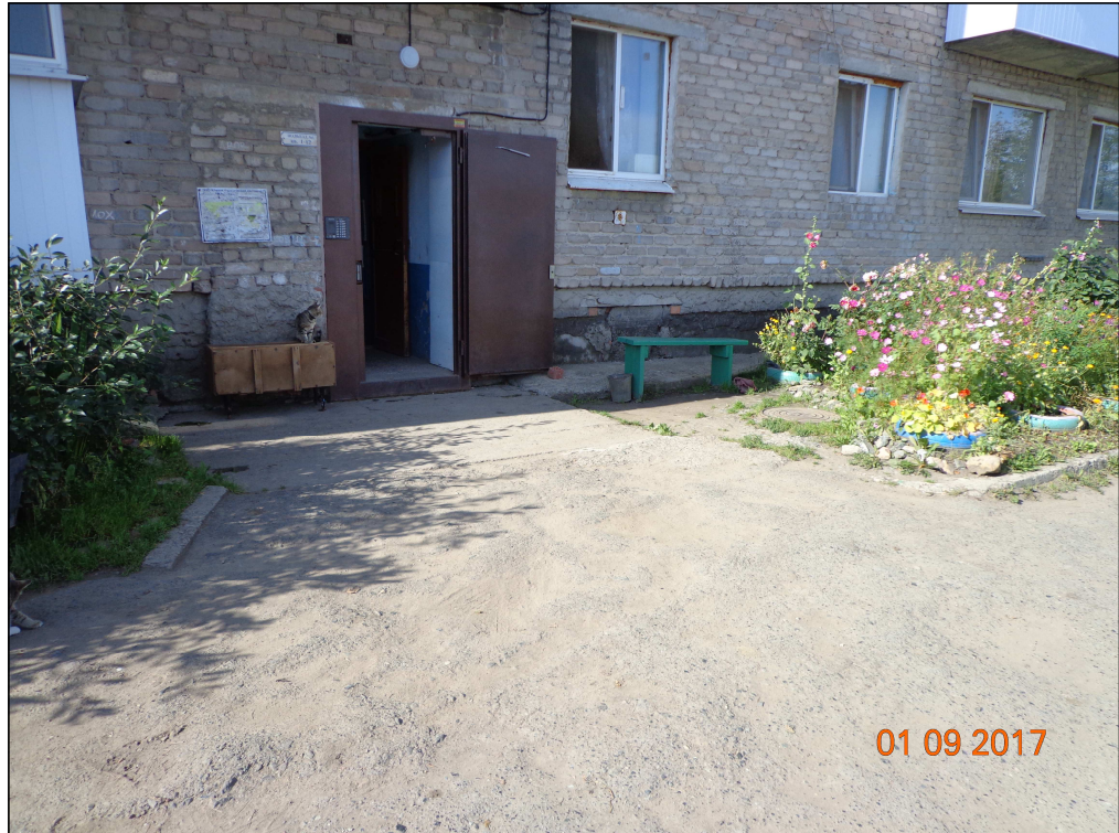
Рис.3. Износ дорожного покрытия. Отсутствие ограждения. Износ бордюрного камня
