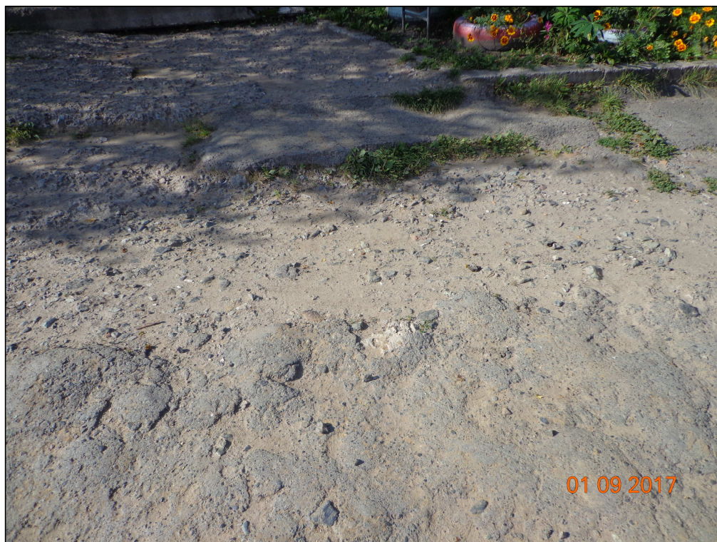
Рис.7. Износ и разрушение дорожного покрытия, выбоины
