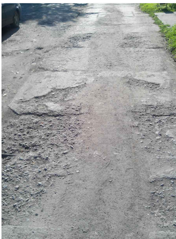
Рис.16. Износ и разрушение поверхности покрытия железобетонных плит
