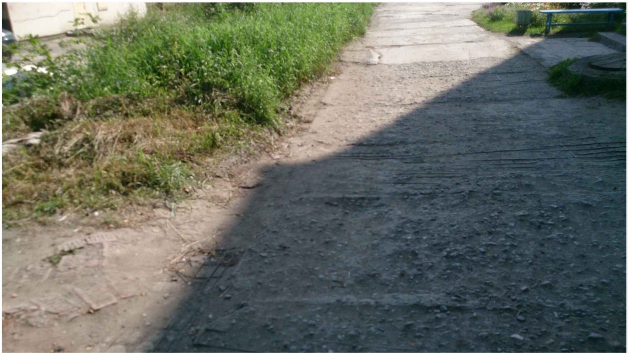
Рис.7. Внутридворовый проезд – износ покрытия железобетонных плит.
