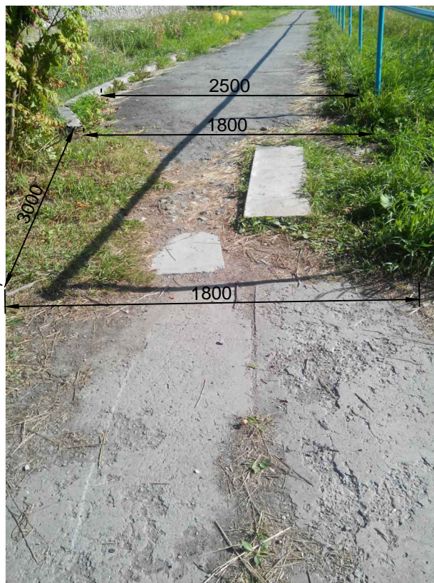
Рис.15. Трещины асфальтового покрытия. Разрушение асфальтового покрытия в виде выбоены размером 3.0x1.8м. Отсутствие бортового камня в месте разрушения
